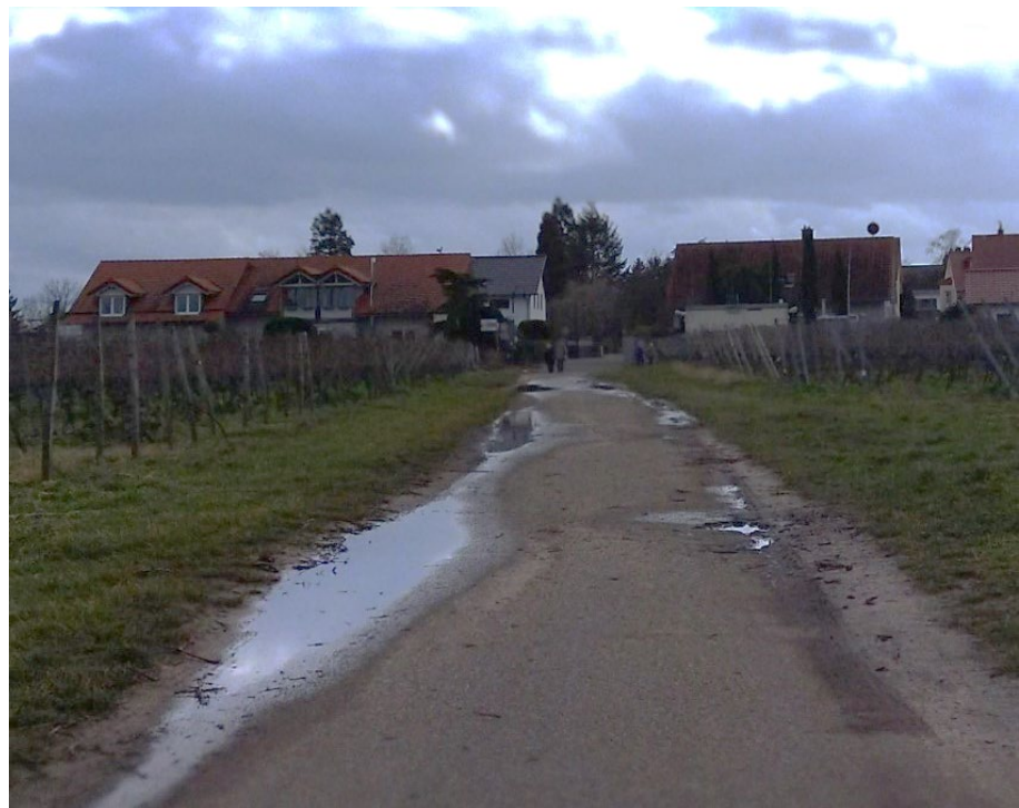
Abbildung 5-6: Beispiel für einen Betriebsweg mit Sanierungsbedarf in Höhe Im Höhnhausen (Wachenheim a. d. Weinstraße)
