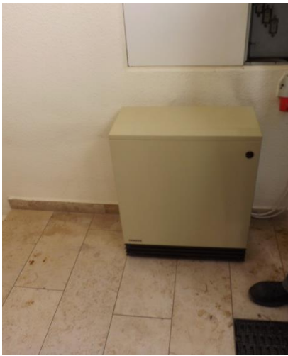
Abbildung 3-2: Beispielaufnahmen zur Erfassung der Heizungsanlage (hier: Nachtspeicher-Zimmerofen des Rathauses Ebertsheim)
