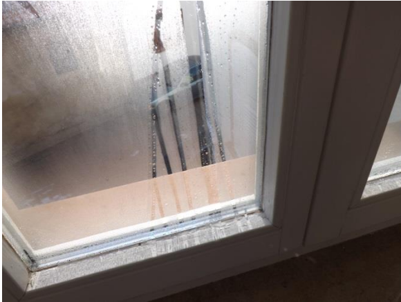
Abbildung 3-3: Beispielaufnahme für eine Mangelerfassung (hier: Tauwasserausfall an der Fensterscheibe)
